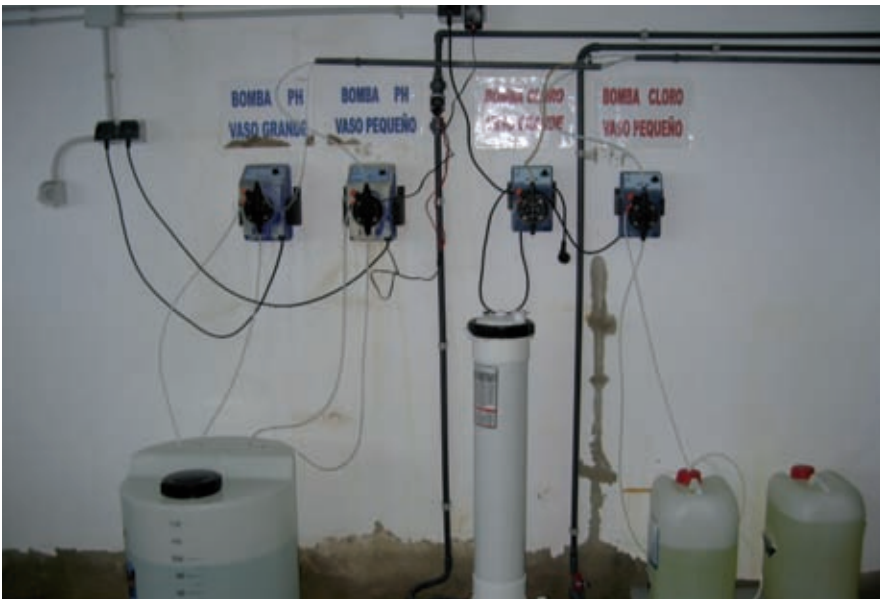
Dosificadores de hipoclorito sódico y ácido clorhídrico en piscina de uso colectivo
